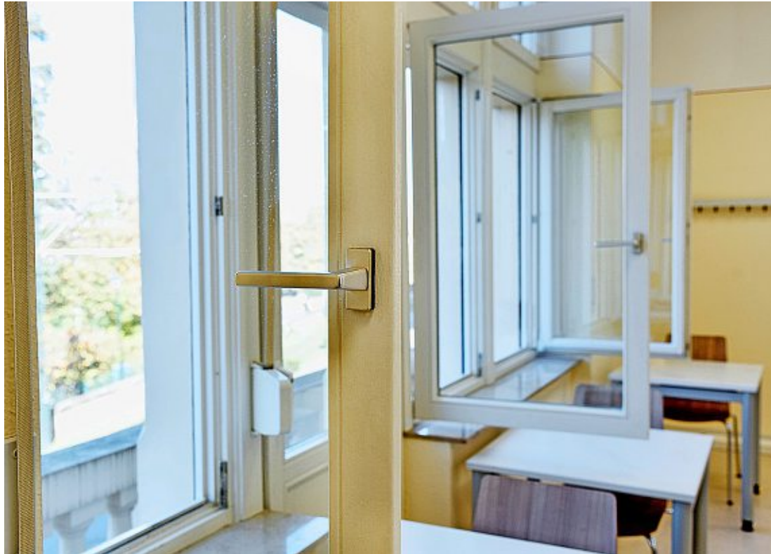
2023 wurden im Baselbiet bis zu 42 Grad in Schulzimmern gemessen. Foto: Imago
