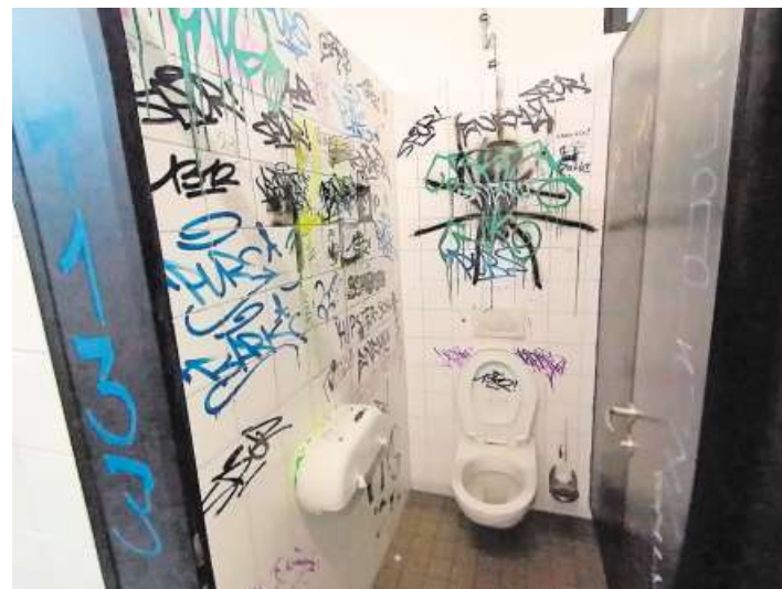
Eine Kabine der Herrentoilette im EG.
