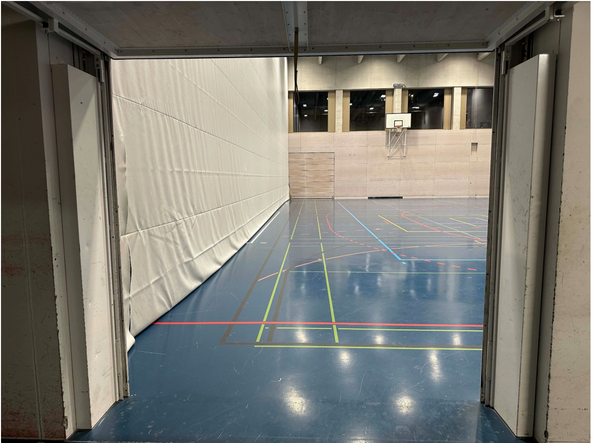
Defekte Trennwand in der Sandgruben-Turnhalle. Bild: zvg
