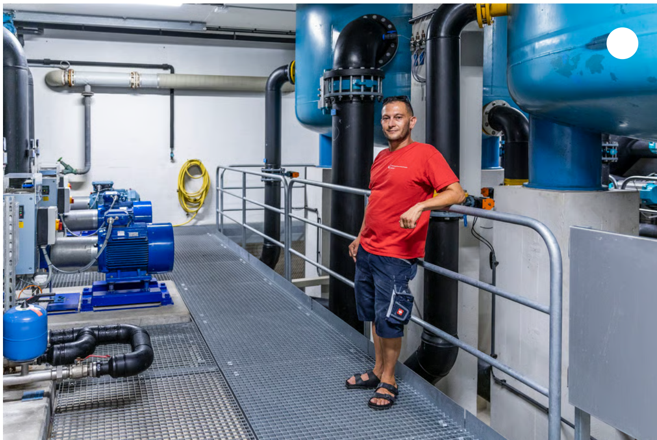
Marco Gagliardi im Wasseraufbereitungsraum. Hinter ihm steht die riesige Filteranlage.
