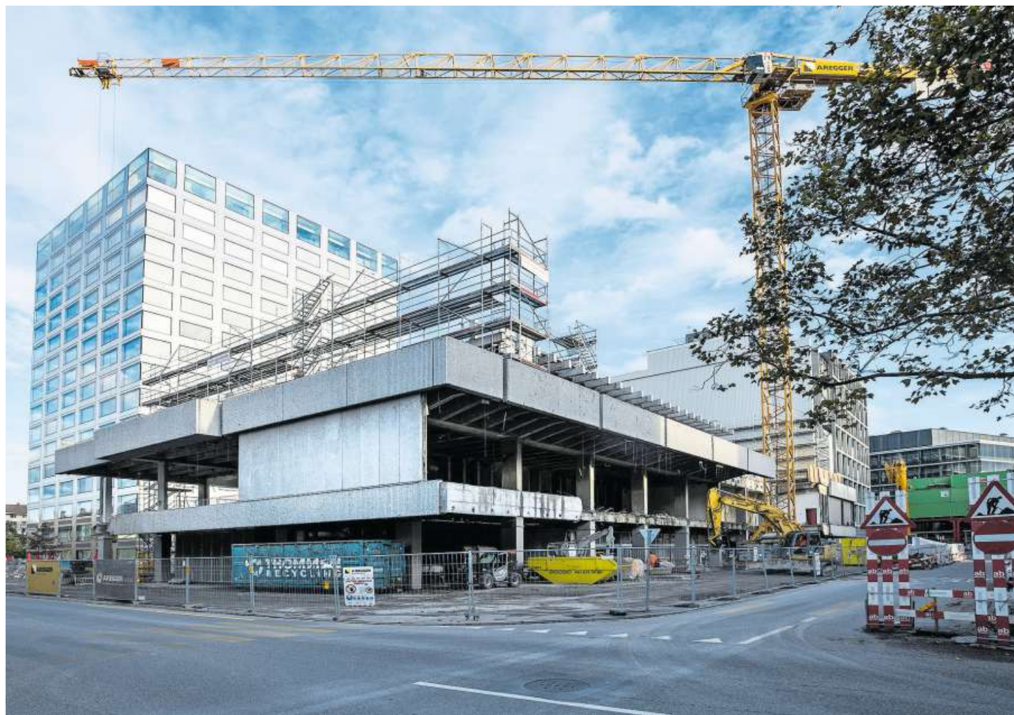
Schon der Abriss des Altbaus kostet acht Millionen Franken mehr als geplant.
