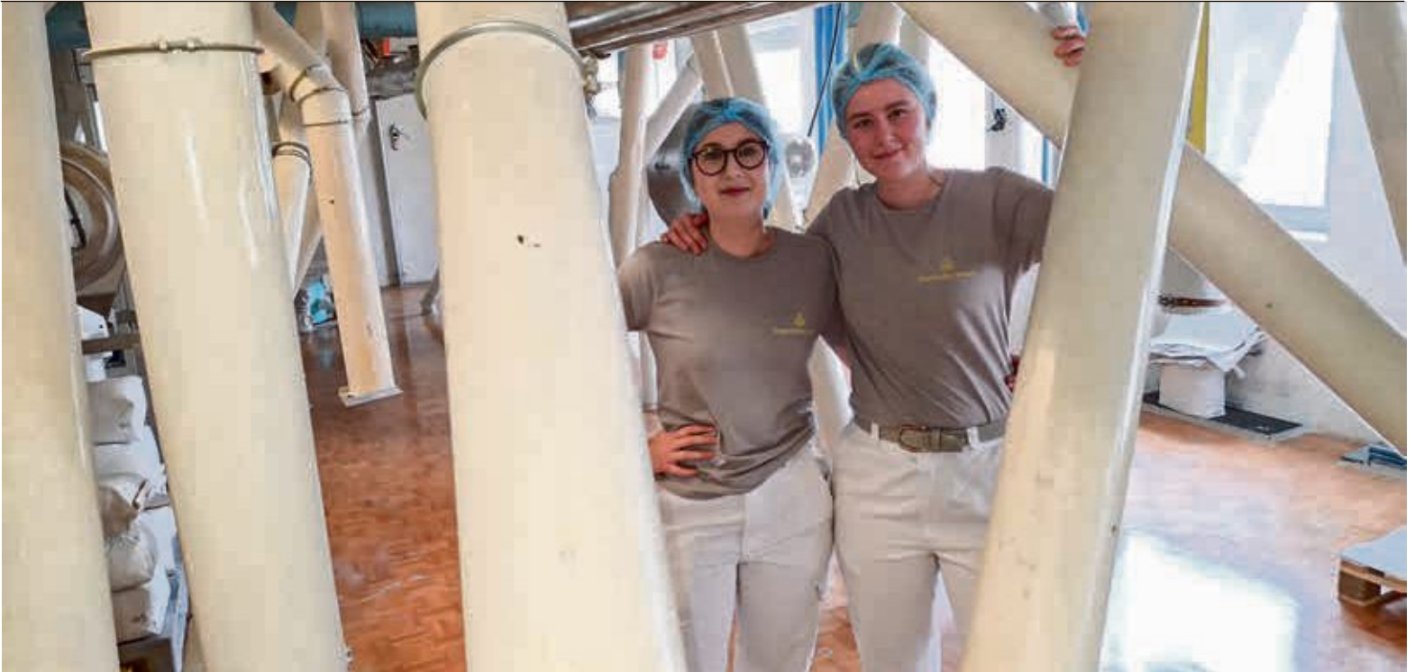
Rahel Pfaffhauser (links) und Victoria Treier auf dem Rohrboden. Im komplexen Netzwerk aus Rohrleitungen wird das Mahlgut nach Korngrösse sortiert und verteilt. Bild: ami
