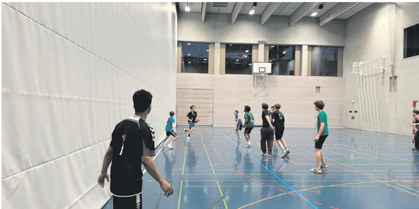
Wegen der defekten Trennwand (l.) müssen die Handballer ihren Anlauf verkürzen. (Bild: zVg)
